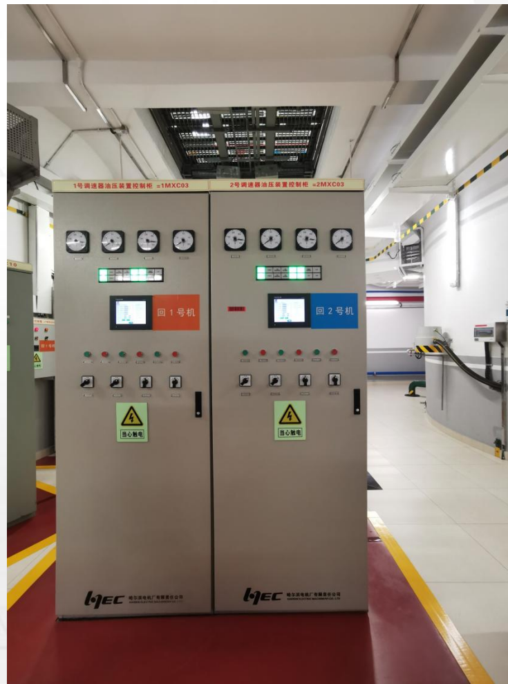
调速器油压装置控制柜
