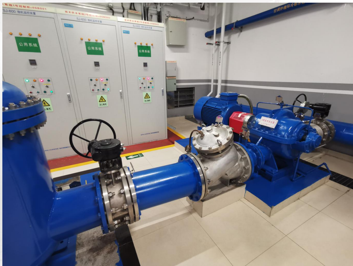
水系统中技术供水及操作柜
