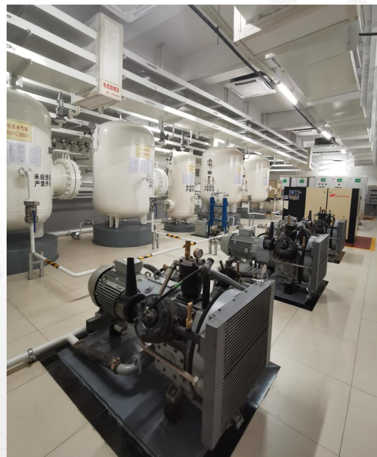
气系统中空压机及储气罐
