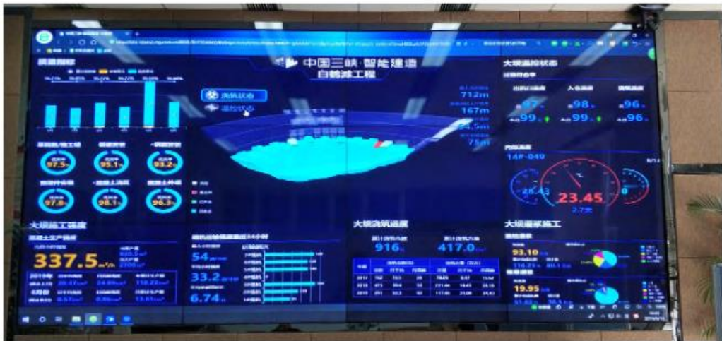
▲智能建造——白鹤滩水电站中控室 摄 / 韦凤年
